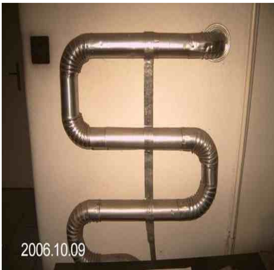
Gázkonvektor "energiatakarékos és szabályos" füstcsövezése...
